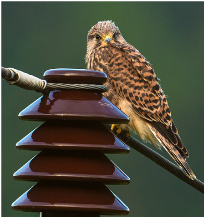
Poštolka obecná na nezabezpečeném vedení vysokého napětí.
