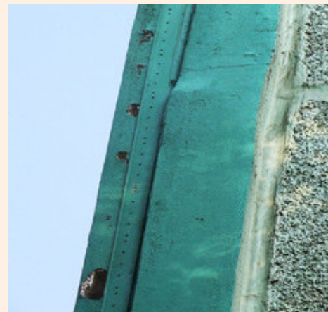
Typické potravní otvory v zateplení
